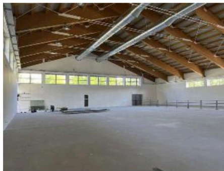
L'attesa nuova palestra della scuola media, funzionale anche alle associazioni sportive, durante la fase conclusiva dei lavori
